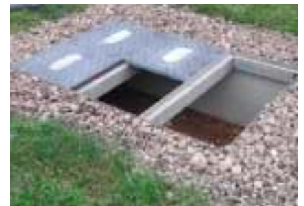
6. Les couvercles PRV sont déposés sur le cadre à l'aide de cannes de levage.
